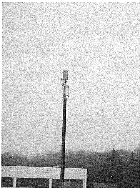
Foto 1: Impianti via C. Cervo
