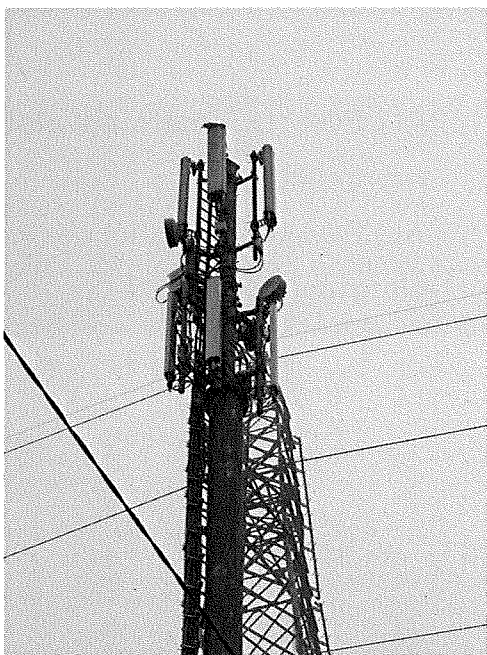
Foto 1: Impianti via Lavino
